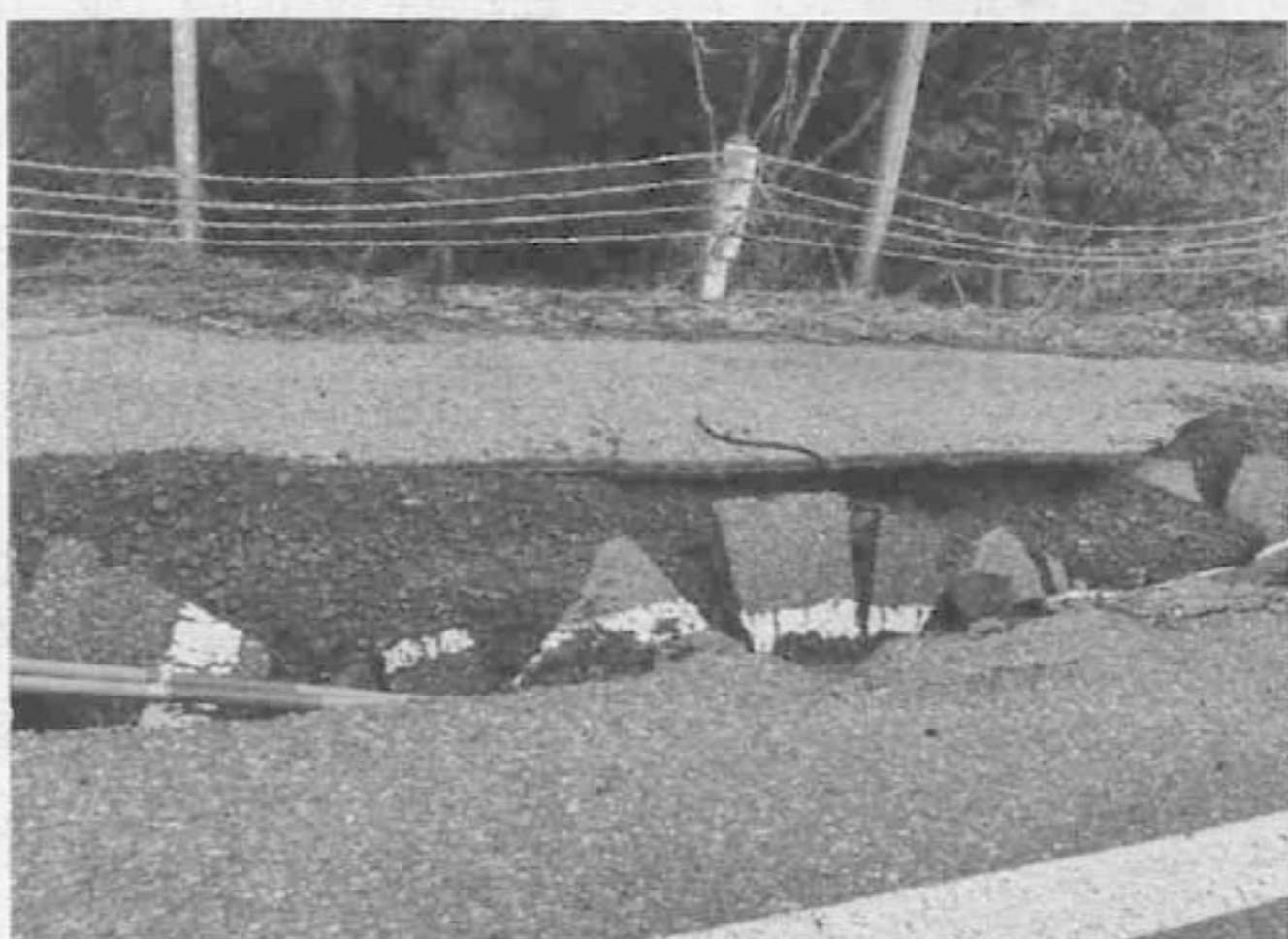
地震により道路が隆起(能登 半島地震、写真ACCより)
